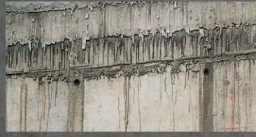
因分層澆置而產生瑕疵， 必須填補修飾的混凝土
