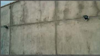
有嚴重色差的 混凝土
