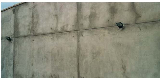
有嚴重色差的混凝土
