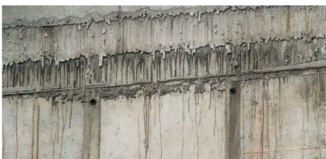
因分層澆置而產生瑕疵，必須填補修飾的混凝土
