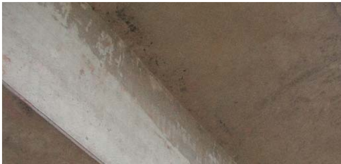
有輕微色差的混凝土
